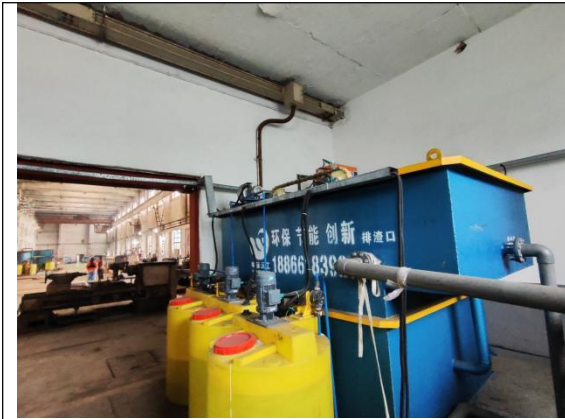
镀铬废水预处理系统
