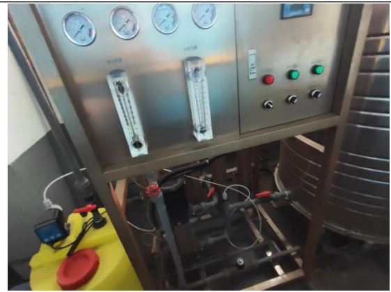
镀铬废水预处理系统
